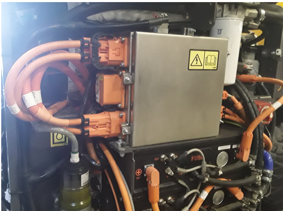
Figuur 6.12 Oranje HV-bedrading - achterkant machine
