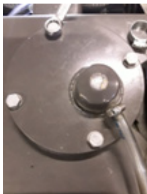
Figuur 6.12 Hydraulische olietank
